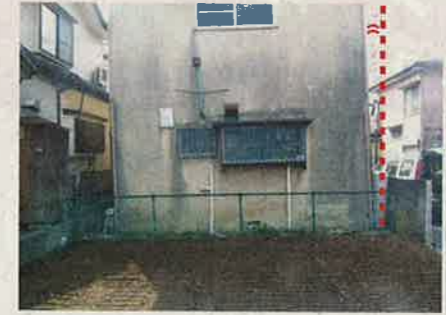
基礎と地盤面にすき間ができていたり、家が傾いていないかチェックしよう（写真/サムシング）
